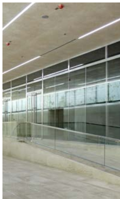
Brandschutzverglasung EI30 – Mercury Tower, Moskau, Russland
